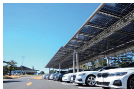
千葉県原市原市ゴルフクラブ 駐車台数：140台 DC容量：430.68kw
