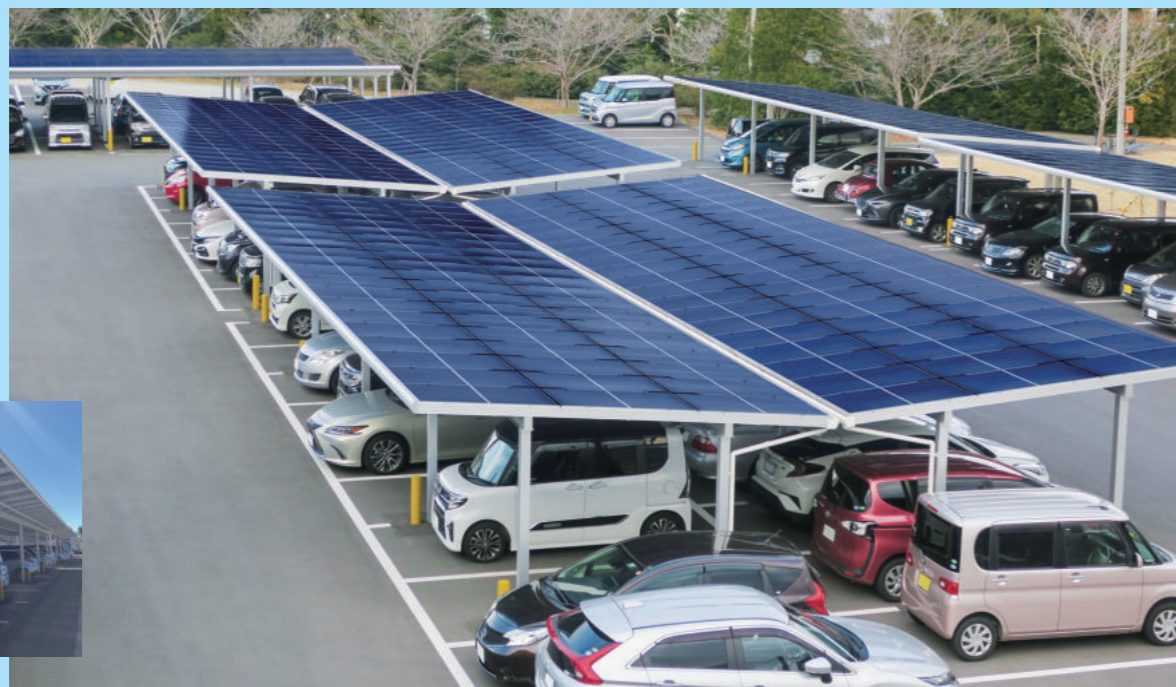
千葉県旭市 食品工場 駐車台数：150台 DC容量：964kw
