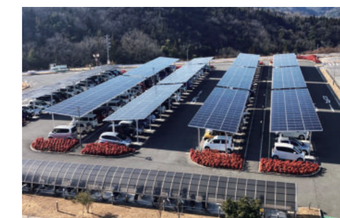
広島県尾道市 配送センター駐車場 駐車台数：356台 DC容量：1081.4kw
