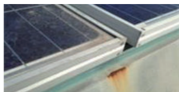
長期間使用時の折板屋根部のサビ被害写真
