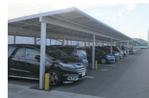
栃木県真岡市 工場従業員駐車場 駐車台数：24台 DC容量：70.2kw
